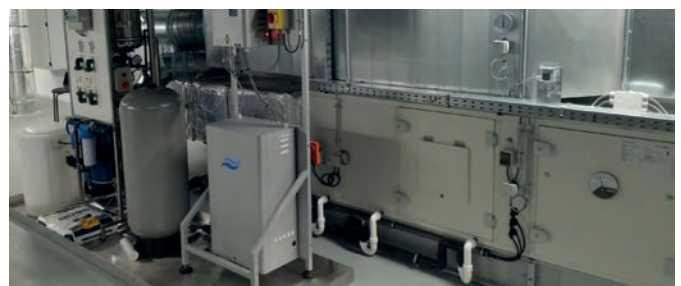
Foto: Installatie in de praktijk
