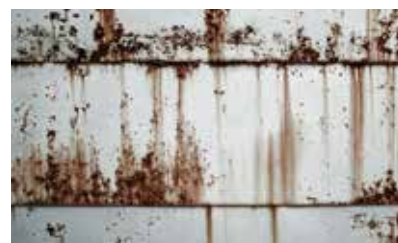
Beschermen tegen roest en corrosie
