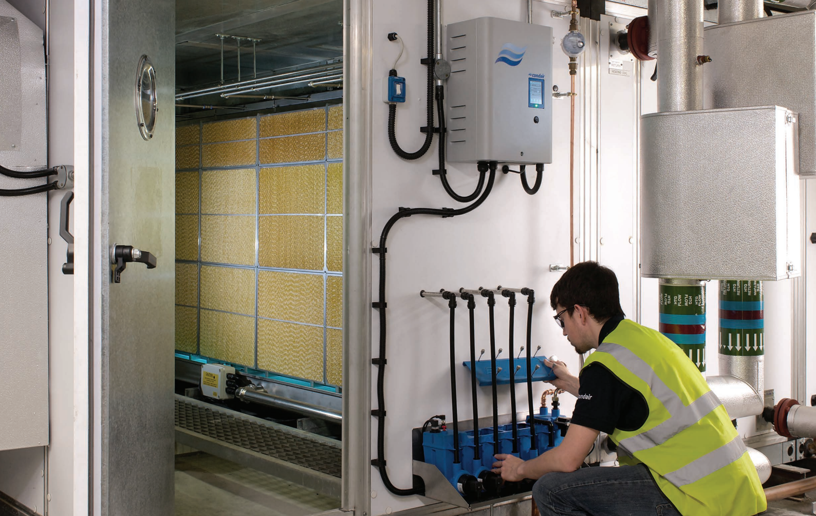
Condair ME met hydraulische unit buiten de luchtbehandelingskast
