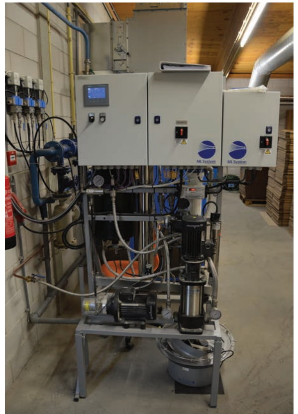
▲ De Centrale Unit van het Condair ML systeem geïnstalleerd in de serviceruimte van het pand.
