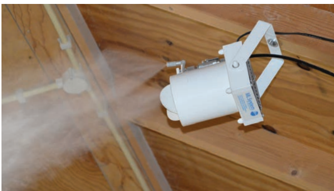
▲ De Condair ML Solo worden gebruikt in de kleinere ruimten van de opslag
